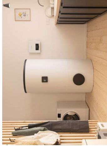
Varmepumpe-løsning med uniSTOR plus med 400 liter
